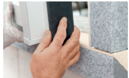
Rys.6 Przygotowana rama pod montaż okna składająca się z profilu instalacyjnego PR007 oraz klina izolacyjnego PR008
