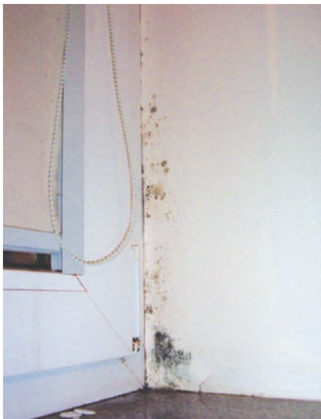
Pleśń w strefach przyokiennych będąca efektem mało wydajnej wentylacji i zimnej przegrody
